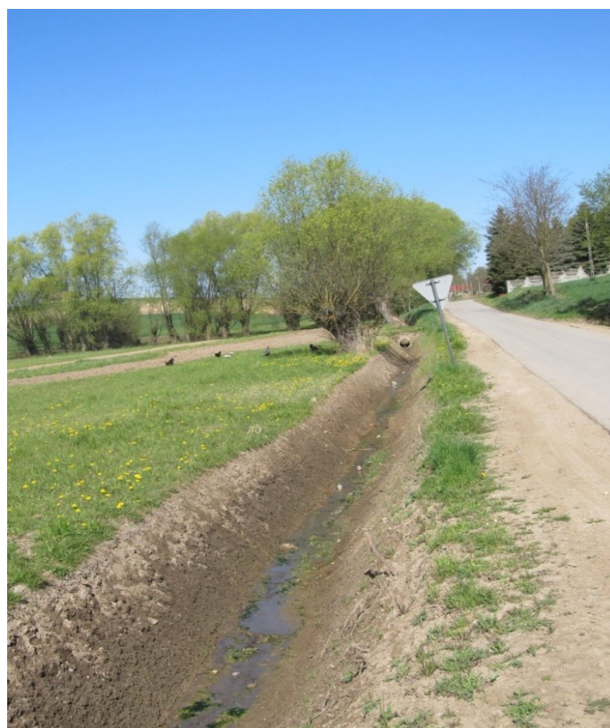
Zdjęcie 17. Małoszów - rowy, przepusty i pobocza.
