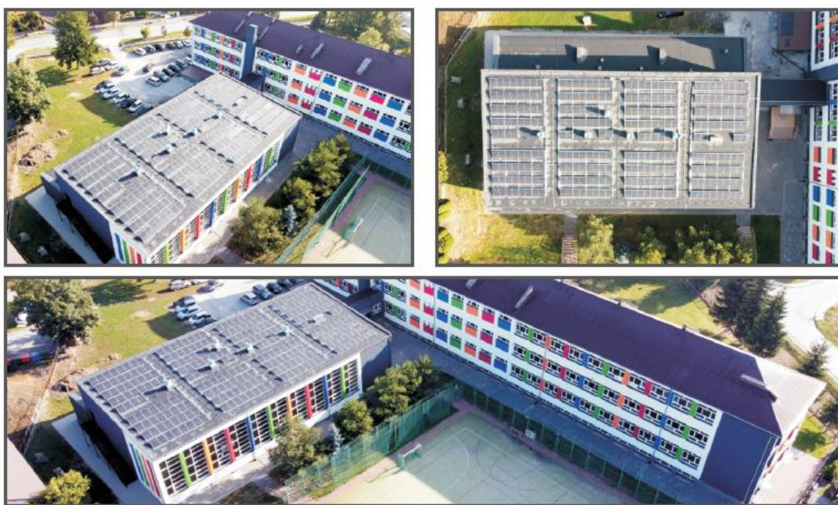
Zdjęcie 2. Instalacja fotowoltaiczna na budynku ZPO w Skalbmierzu
